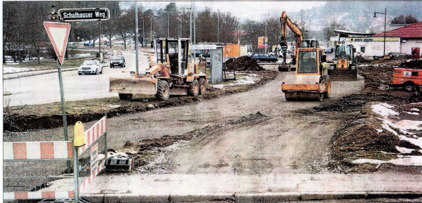
Die Baufahrzeuge legen zunächst eine provisorische Fahrbahn an, bevor die Dätzinger Straße umgestaltet wird
